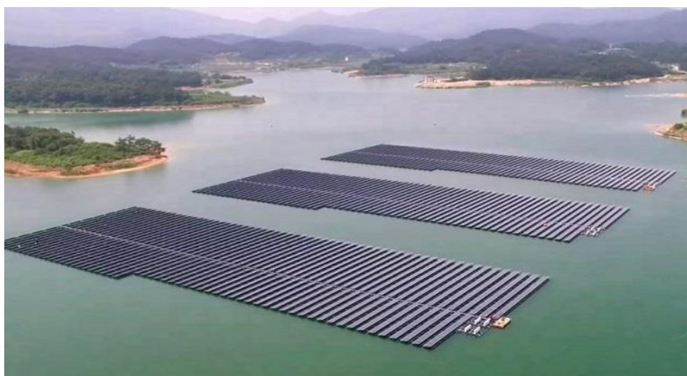
海上的光伏发电装置
